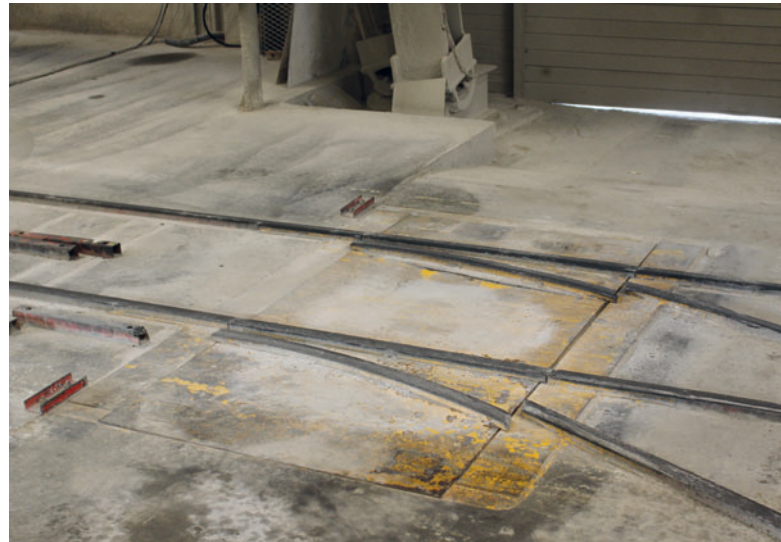
Über eine Weiche können die Hallen automatisch angefahren werden.
