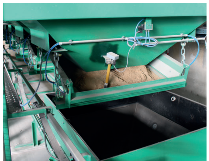
Für die Feindosierung wurden Vibrationsrinnen vorgesehen.
